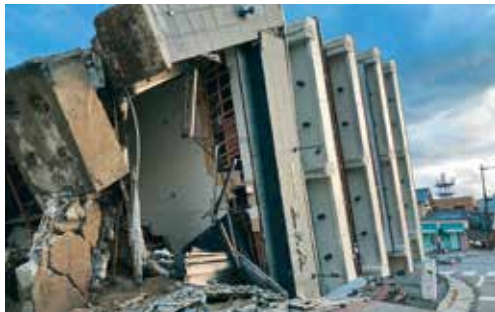
倒壊した7階建てビル
